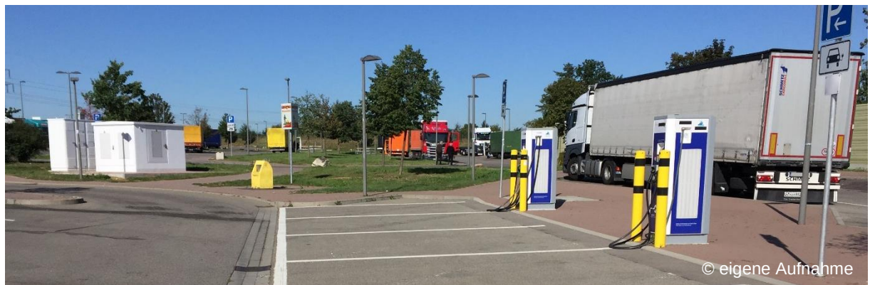
Abbildung 3-13: Ladesäulen an der Raststätte Denkendorf Nord (Betreiber EnBW AG)
