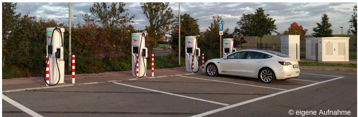
Abbildung 3-14: Ladesäulen an der Raststätte Denkendorf Nord (Betreiber IONITY GmbH)
